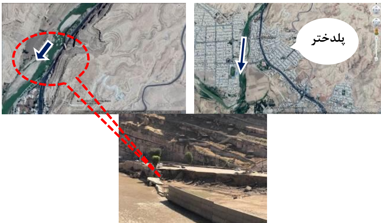
شکل ۱- تخریب دیوار بتنی با ارتفاع کافی و ورود سیلاب به داخل شهر پلدختر بدلیل عدم اتصال مناسب به کناره موجود
