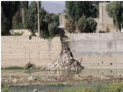
شکل ۵- عدم اتصال مناسب دیوار حفاظتی به سازه موجود و عدم تطابق سازه های حفاظتی
