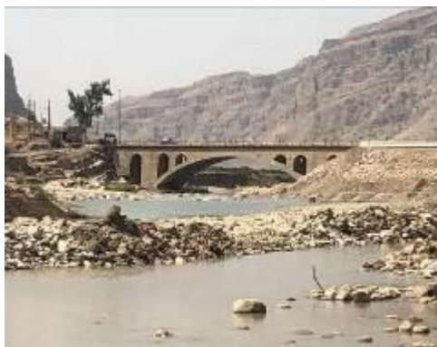
شکل ۶- زاویه استقرار نامناسب پل جاده پلدختر- کرمانشاه و انسداد جریان و تخریب دایک حفاظتی بابازید
